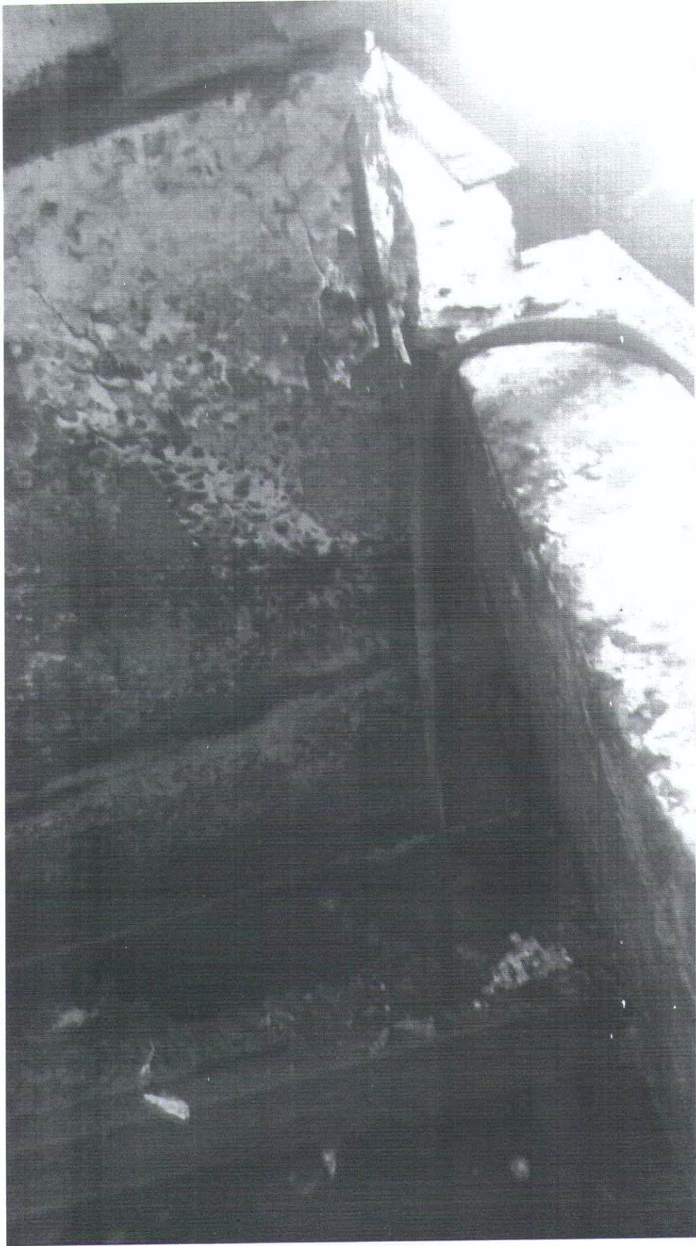
Фото № 6 (слив теплоносителя в канализационные отстойники)
