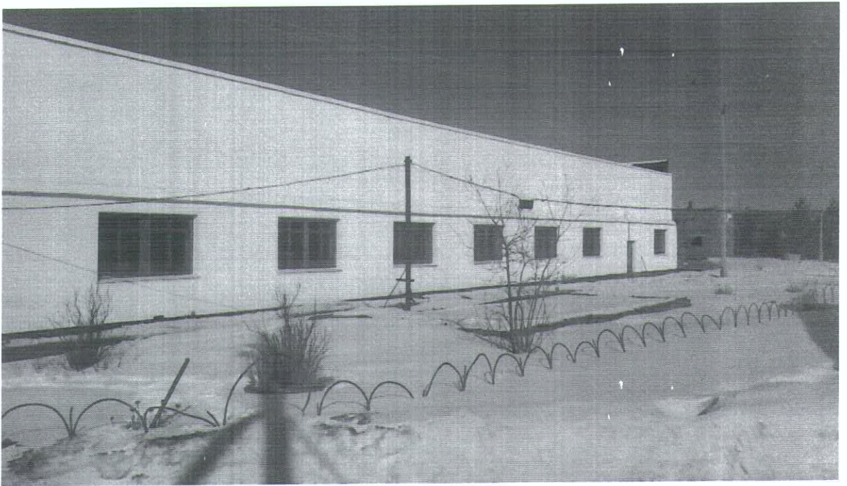
Фото № 3 (отсутствие замены окон)
