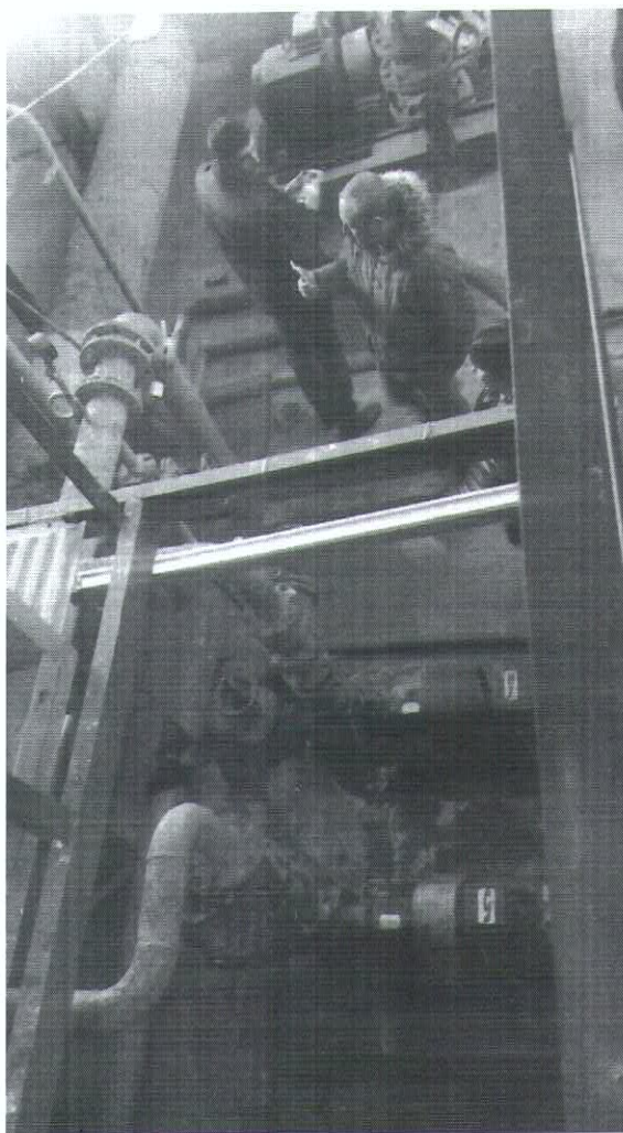
Фото № 2 (общий вид насосов на водозаборе второго подъема)
